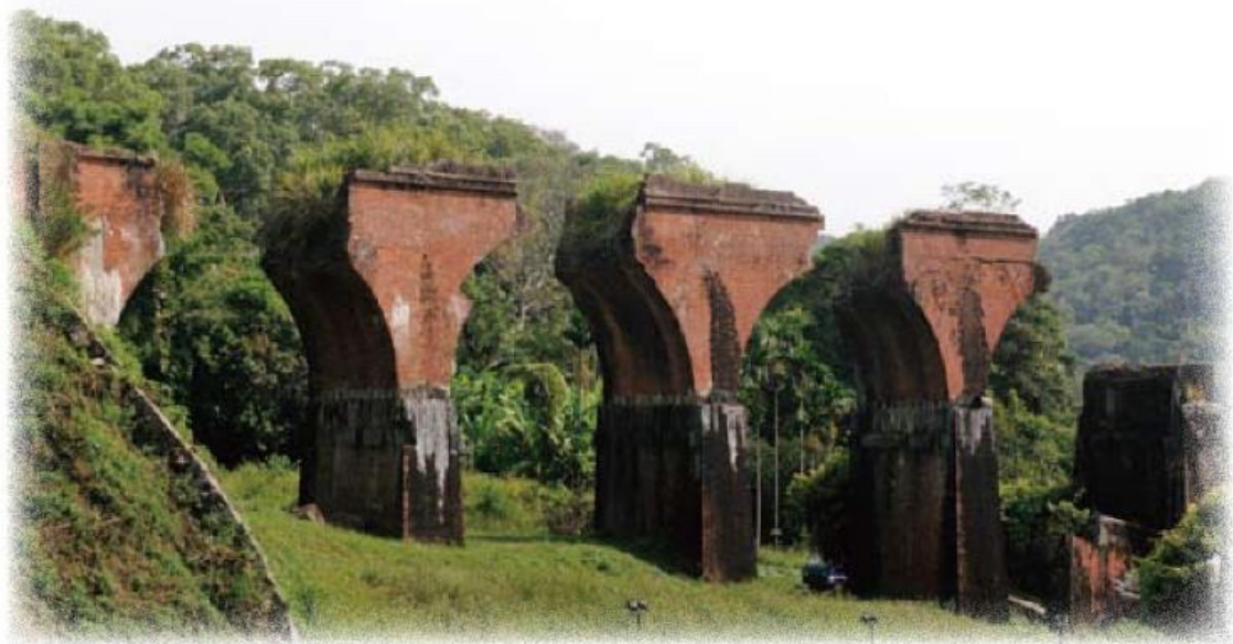
▲ 由於南庄大地震而損毀的魚藤坪橋，如今僅剩紅磚造的橋墩供後人緬懷。（攝影／陳柏靜）
