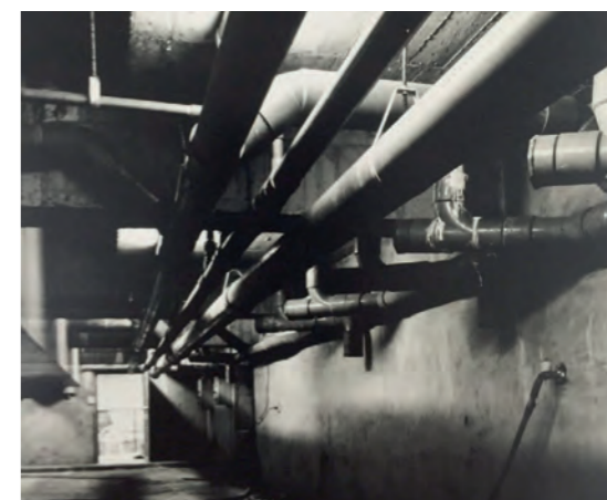
加設的管道層，方便工作人員日後維修。
